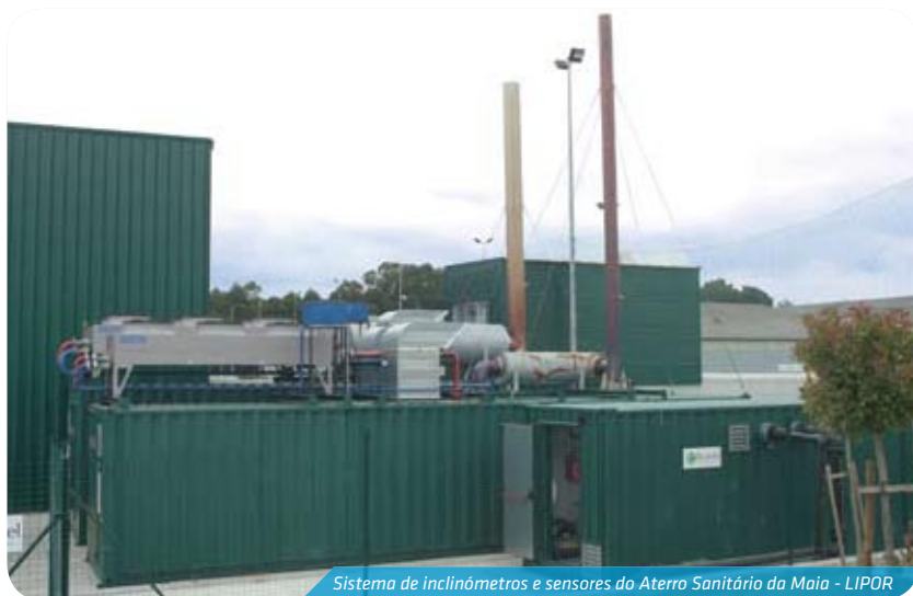
Sistema de inclinómetros e sensores do Aterro Sanitário da Maia - LIPOR
